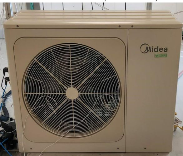
Gesamtansicht Ausseneinheit (General view ODU)
