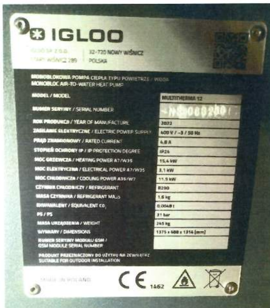
Fot. 1 Błędna tabliczka znamionowa Photo 1 Incorrect nameplate
