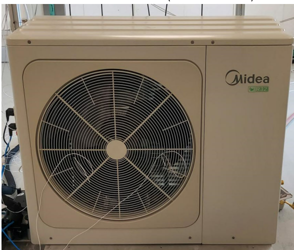
Gesamtansicht Ausseneinheit (General view ODU)
