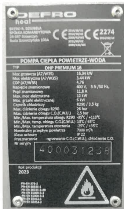
Fot. 3 Tabliczka znamionowa urządzenia Photo 3 Device nameplate
