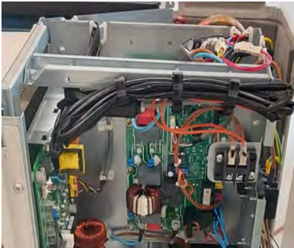
Elektrische Einheit ODU (Electrical unit ODU)
