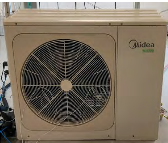
Gesamtansicht Ausseneinheit (General view ODU)
