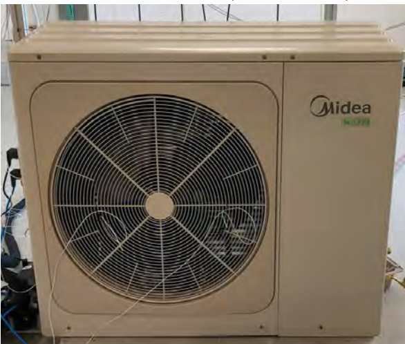
Gesamtansicht Ausseneinheit (General view ODU)
