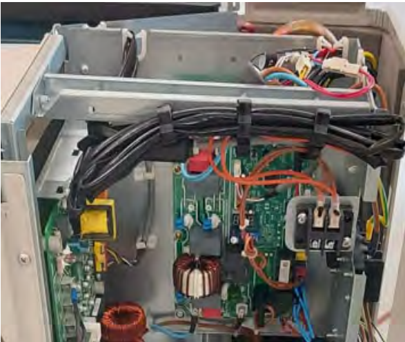
Elektrische Einheit ODU (Electrical unit ODU)
