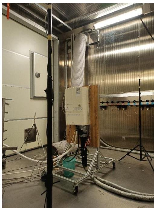
Figura 6 – Installazione dell'unità interna della sorgente di rumore nella seconda posizione (position 2) – Installation of the indoor unit of the sound source in the second position (position 2).)
